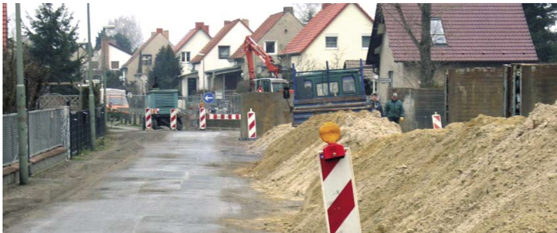
Geht es nach Rot-Rot, „renovieren“ demnächst die Bürger hier selbst. Jedenfalls müssen sie zahlen.
